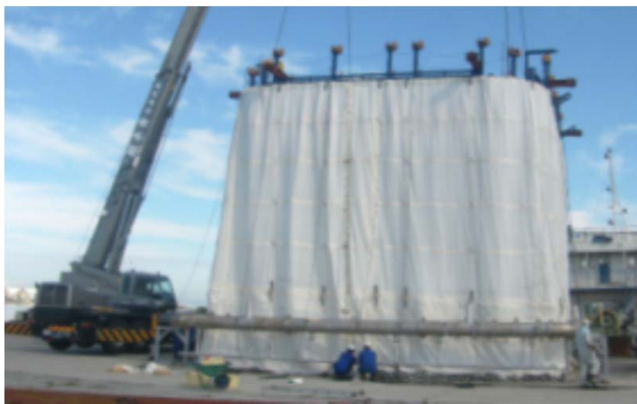
改造した流速軽減膜装置
