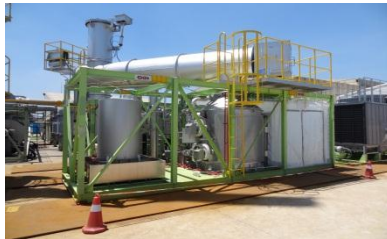
小型焼却炉設備 (小型焼却炉)
