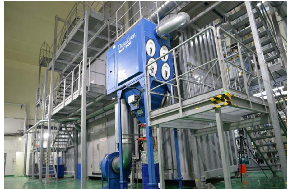
加熱爆破処理設備【川崎重工業株】
