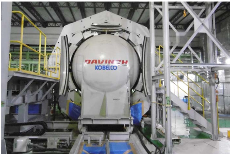
制御爆破処理設備【株神戸製鋼所】
