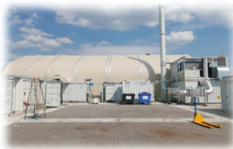
展開した設備全景(概要) 後方は処理設備の格納テント
