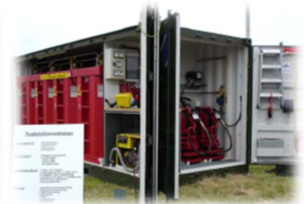
コンテナ外観(設備収納時)
