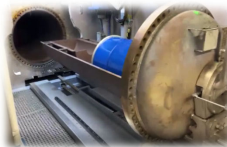
高機動処理設備Ⅱ型 きい剤補給容器(200Lドラム缶)装荷
