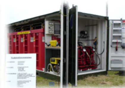
コンテナ外観(設備収納時)
