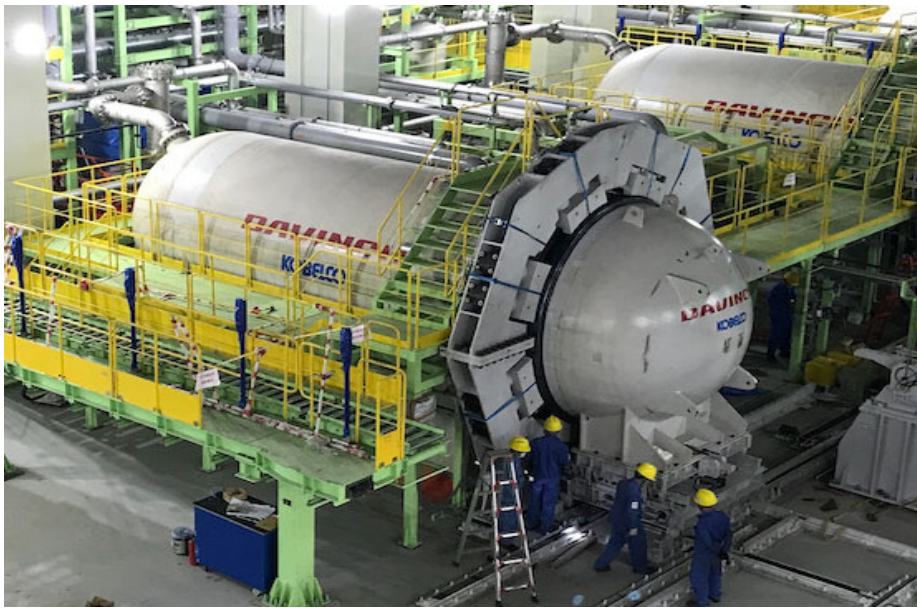
大型廃棄処理設備【株神戸製鋼所】
