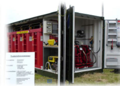
コンテナ外観(設備収納時)
