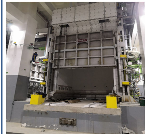
【台車型炉】 （金属廃棄物(弾ガラなど)を処理する)
