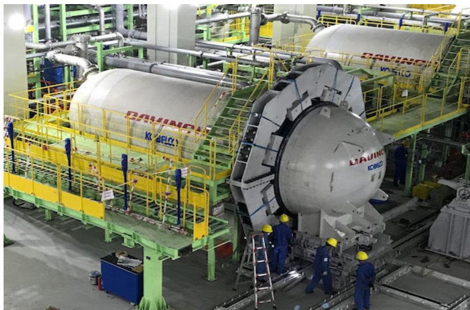
大型廃棄処理設備【株神戸製鋼所】
