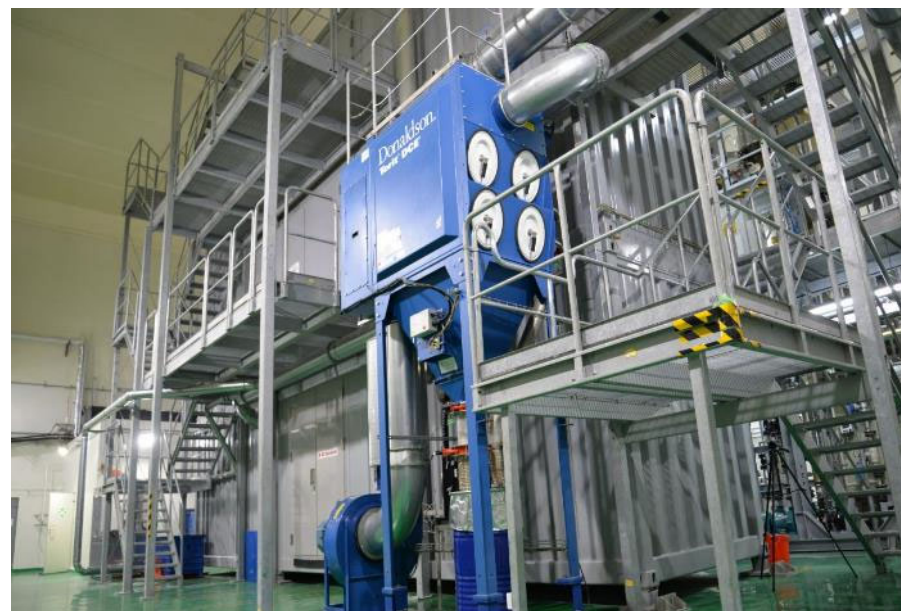
加熱爆破処理設備【川崎重工業株】
