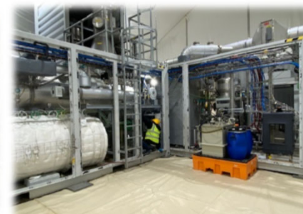
コンテナ外観(設備収納時)
