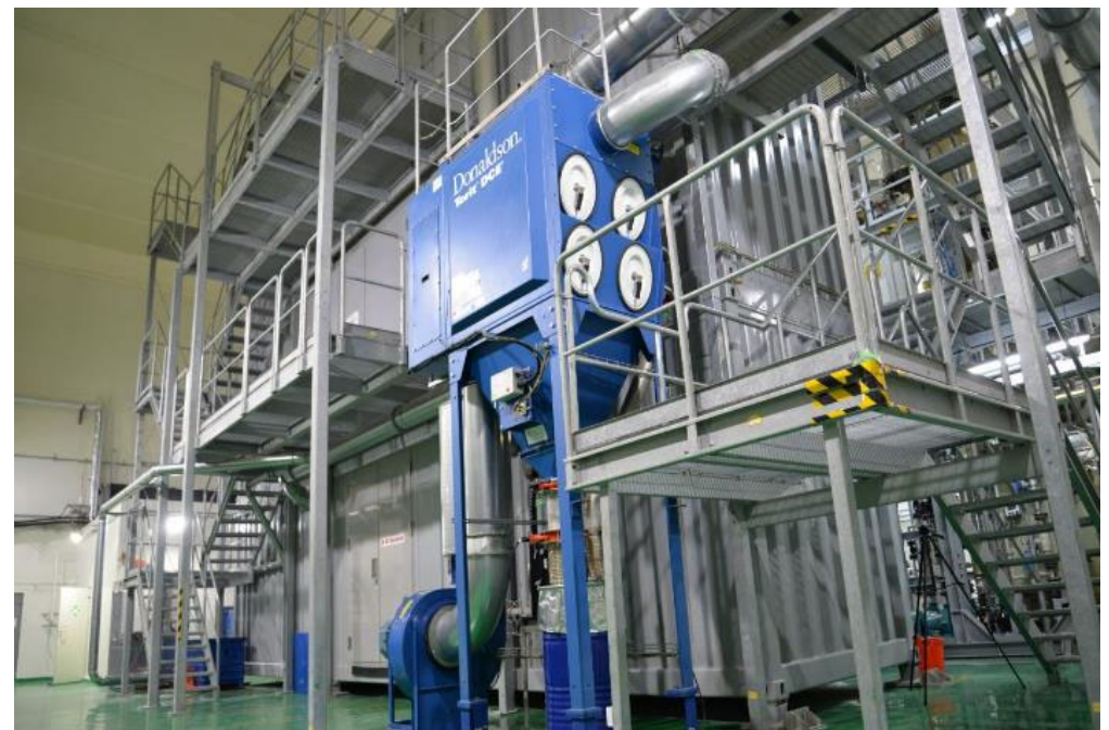
加熱爆破処理設備【川崎重工業(株)】
