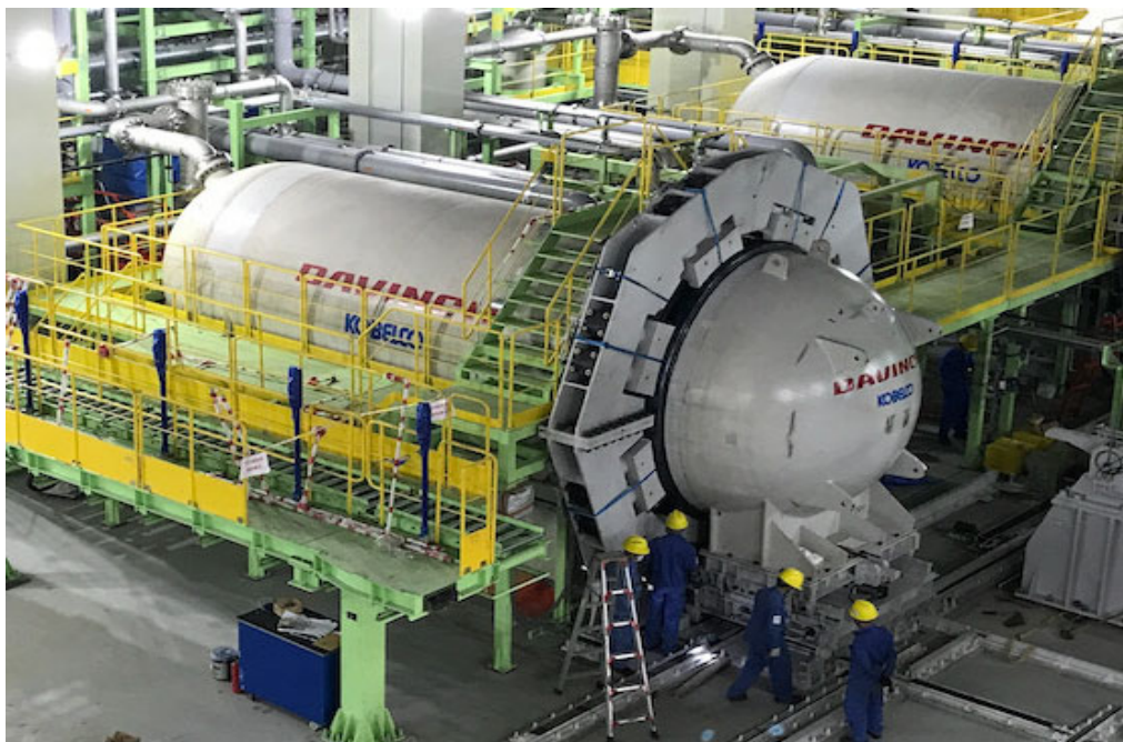
大型廃棄処理設備【(株)神戸製鋼所】
