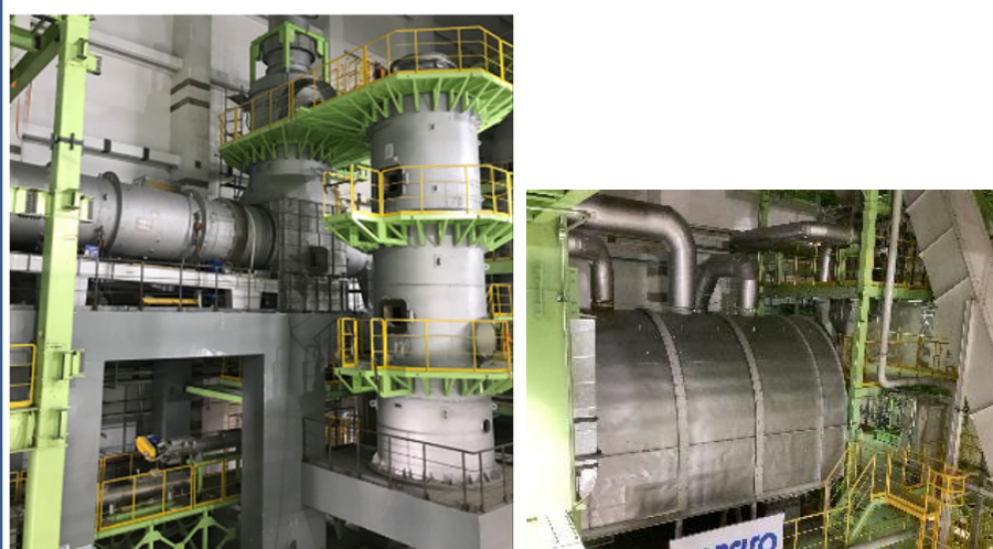
【ロータリーキルン】 (固体廃棄物(ウエス、こん包材など)を処理する)
